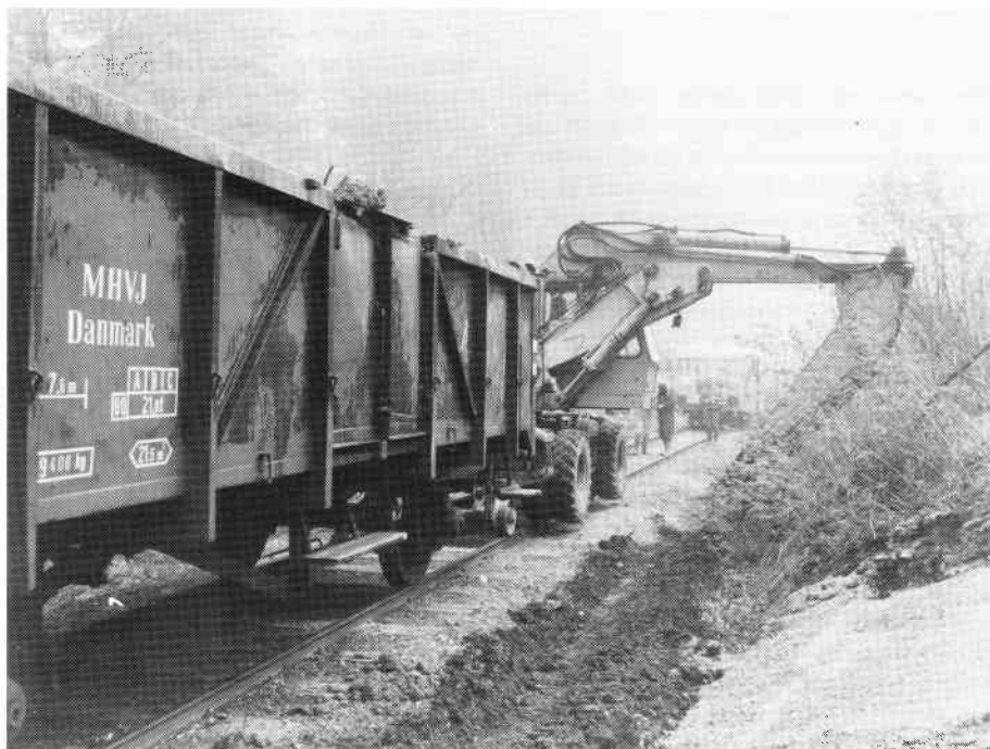
Dæmningsskred mellem Lunddalen og Mariager på MHVJ, foråret 1992. 800 kbm jord måtte i hast flyttes for ikke at hindre toggangen. Arbejdet kom til at tage otte dage!
