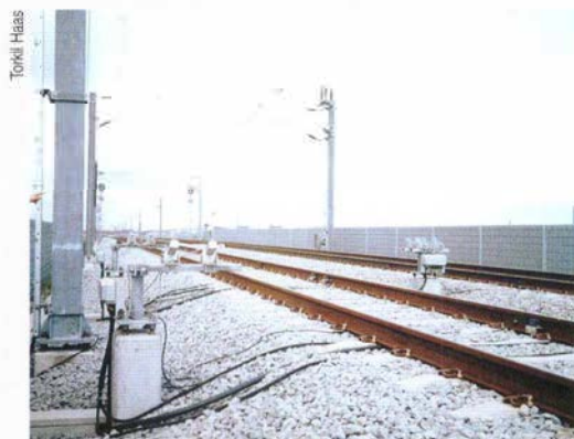
Vognkontrolanlæg ved Kalvebod station
